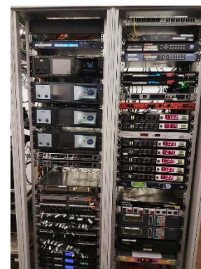
Ein Tower im Server-Raum
